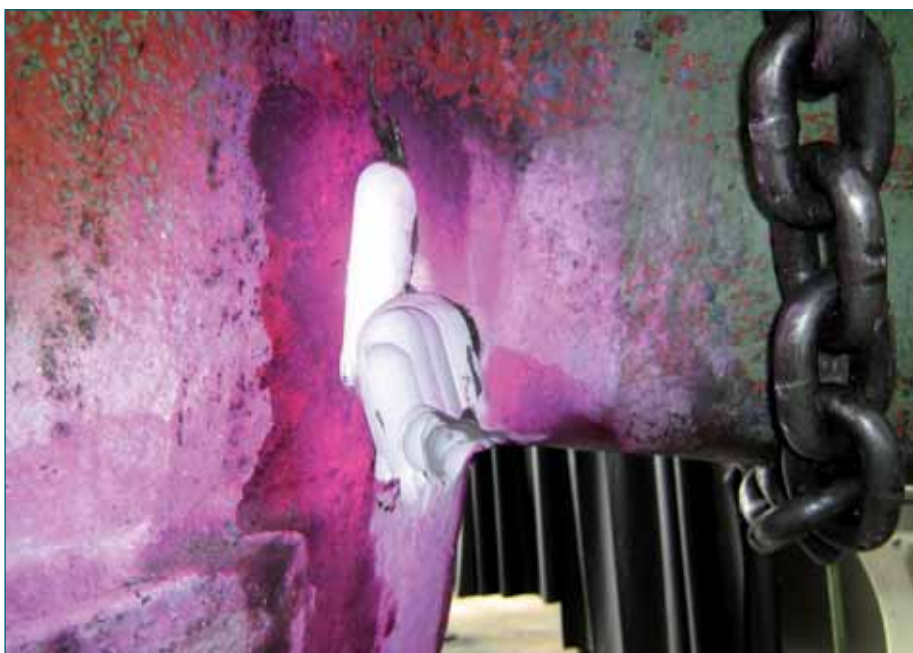
Herausgefräste Risse im Bereich der Säulenanbindung an den Zylinder, vor dem Reparaturschweißen im alten Kopfstück. (Bilder: Presstec)
